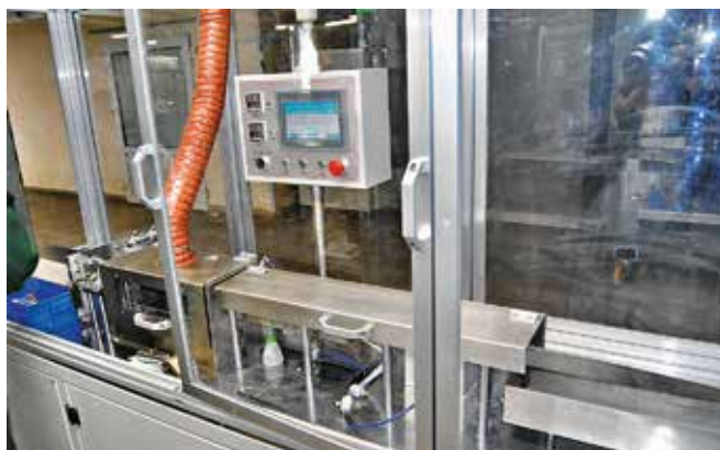
Модули предварительного нагрева и пайки выводов новой линии
