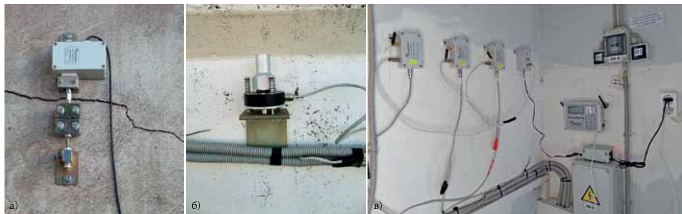
Рис.1. Размещение элементов системы конструкционной безопасности зданий и сооружений: датчик деформации (а), инклинометр (б), ретрансляторы сигналов датчиков (в)
