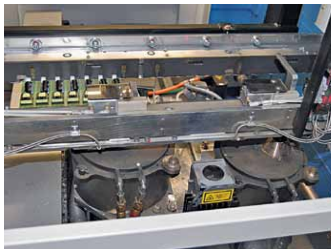
Внутреннее пространство установки SelectLine-C
